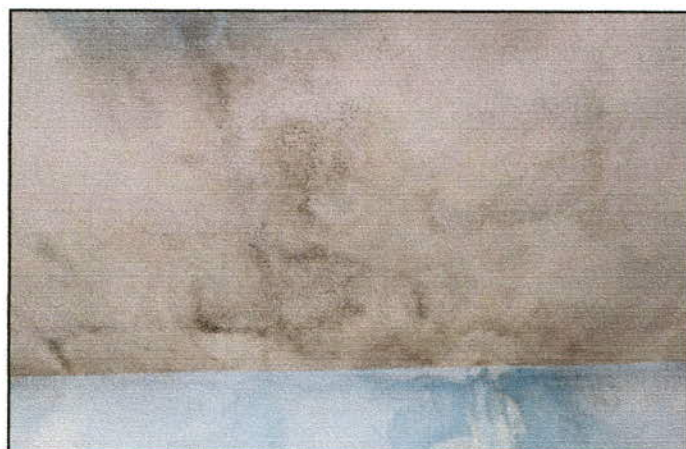
FIGURA 04 - Manchas no teto
