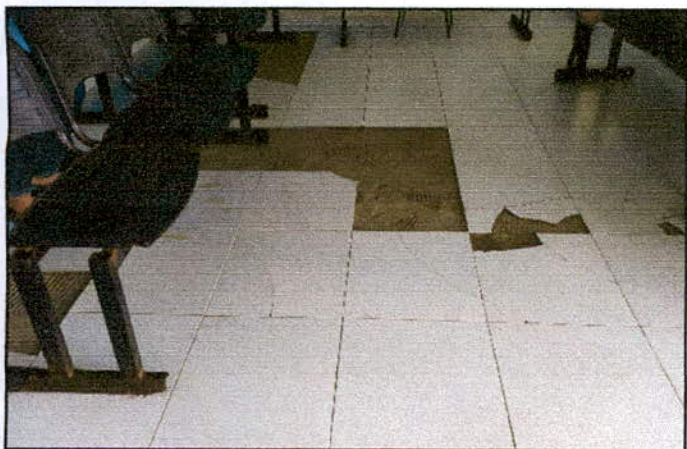
FIGURA 03 - Revestimento cerâmico quebrado
