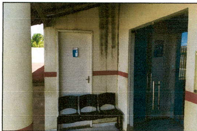
FIGURA 02 - Manchas na parede e porta danificada
