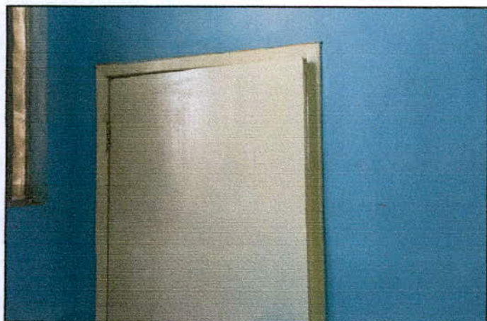
FIGURA 05 - Salas sem placas de identificação
