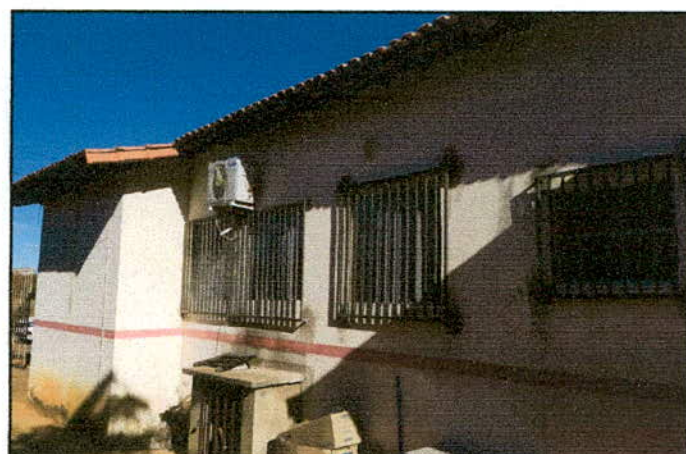
FIGURA 06 - Pintura externa danificada
